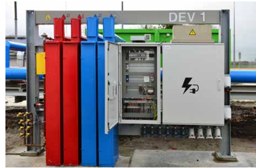
Tussenstation DEV 1. De DEV's leveren onder andere koud en warm water, aardgas, drinkwater, elektriciteit en datavoorzieningen. Onderzoekers kunnen dit gebruiken tijdens hun onderzoek en vervolgens ook weer terugleveren aan de ETB.
